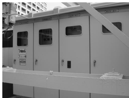
受変電設備（キュービクル型）
