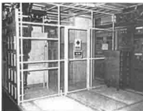
受変電設備（電気室型）
